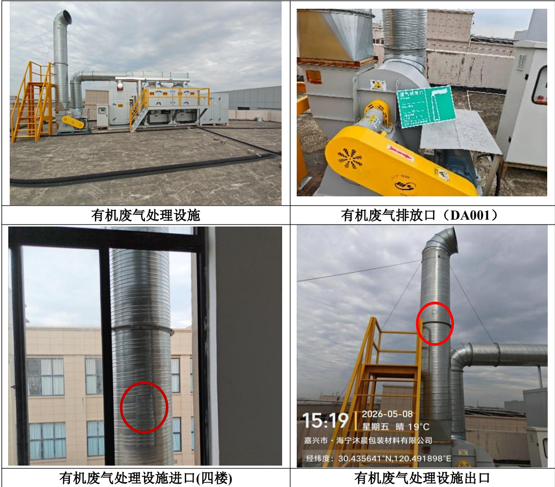
图 3-2 废气处理设施及排放口照片
