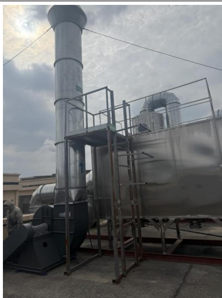
6 号楼废气处理设施
