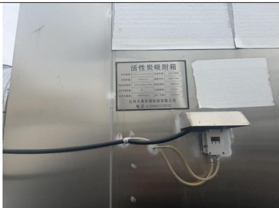
6号楼废气处理设施
