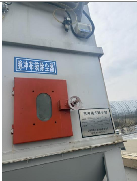
1号楼废气处理设施
