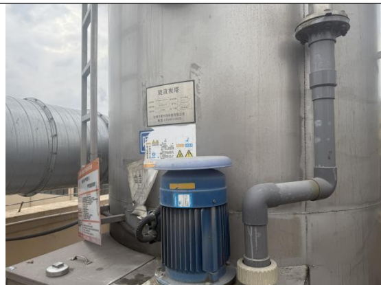
6号楼废气处理设施
