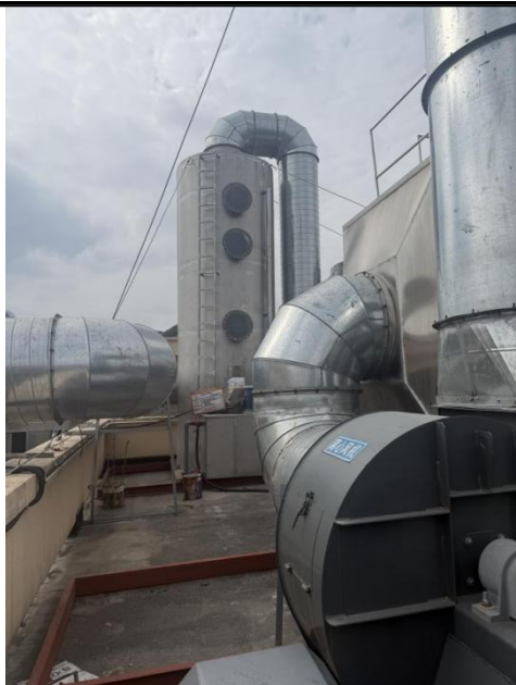
6号楼废气处理设施
