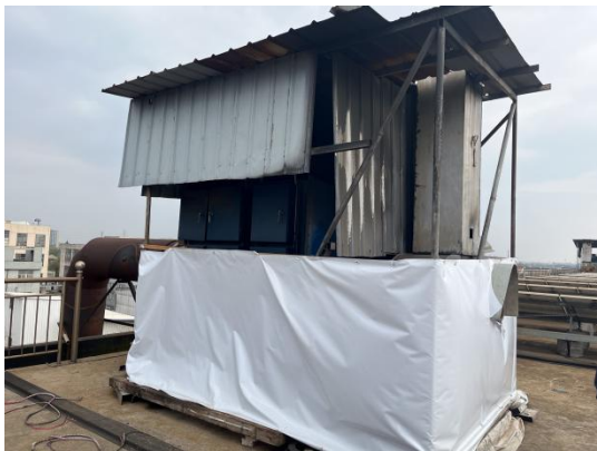
贴合废气 1 处理设施
