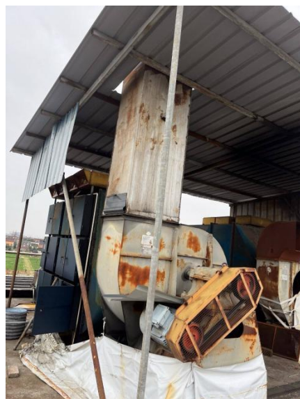
贴合废气 2 处理设施
