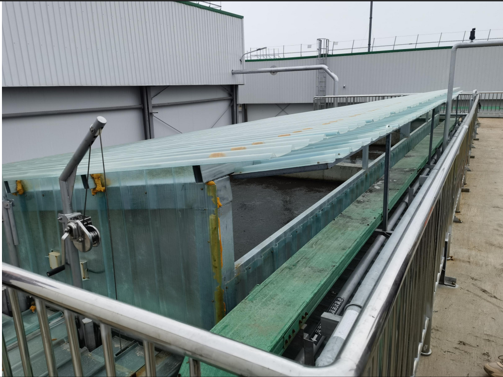
废水处理设施
