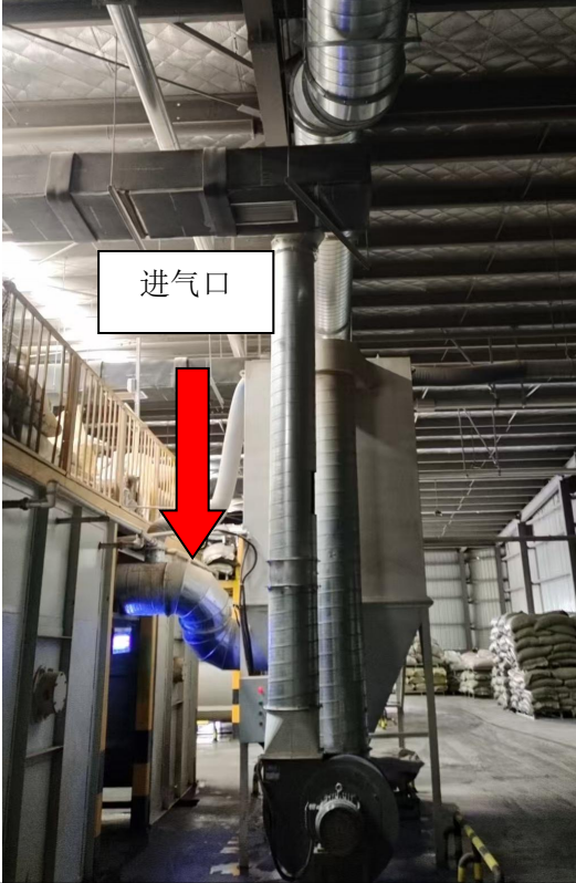
配料、搅拌废气进口及处理设施
