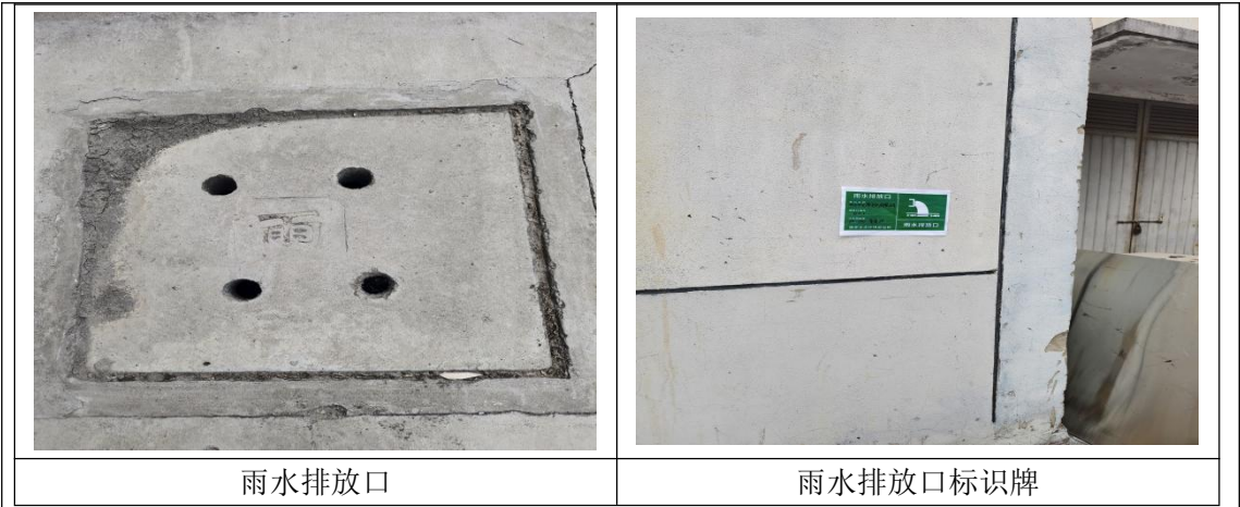
图 3-3 排放口标识牌
