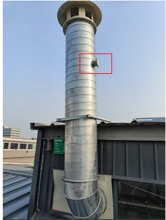
奉口村厂区抛光废气排气筒
