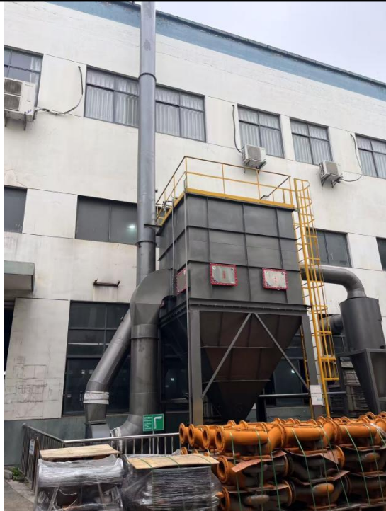
东风村厂区抛光废气处理设施
