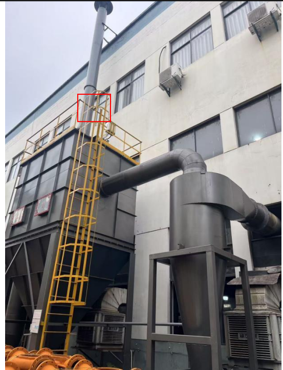
东风村厂区抛光废气排气筒
