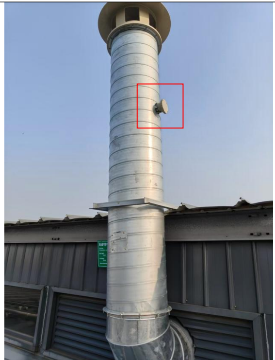
奉口村厂区喷砂废气排气筒
