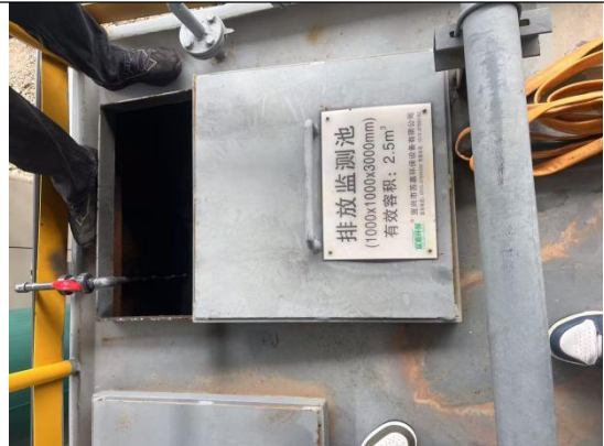
奉口村厂区污水站出水口
