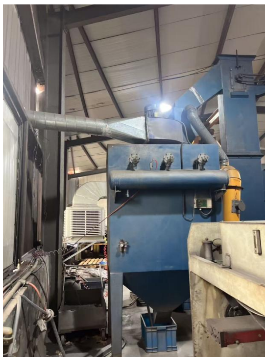
东风村厂区抛丸废气处理设施
