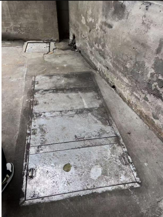
东风村厂区隔油池、沉淀池
