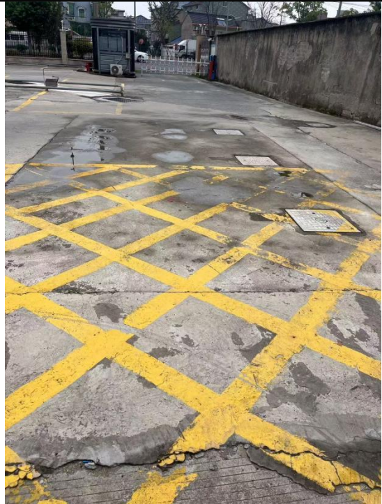
东风村厂区三级隔油池
