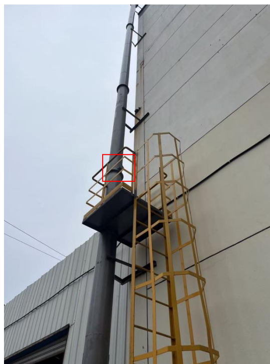
东风村厂区抛丸废气排气筒
