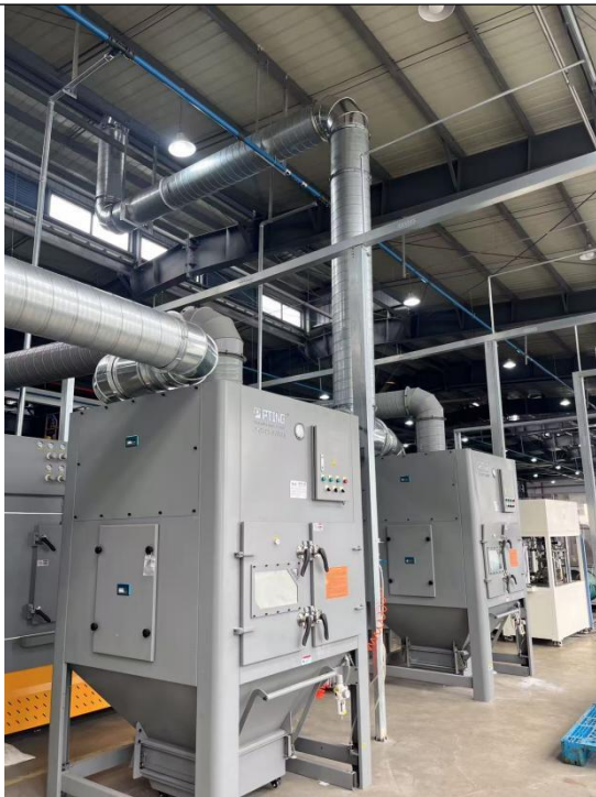
奉口村厂区喷砂废气处理设施
