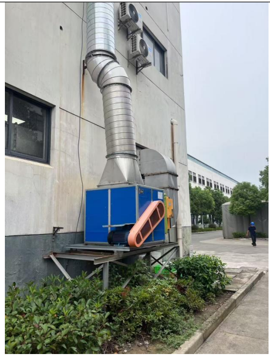
东风村厂区食堂油烟废气处理设施
