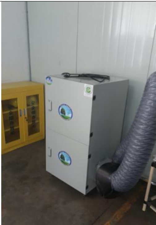
东风村厂区补漆废气处理设施
