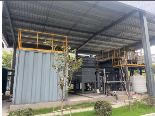
奉口村厂区污水处理站
