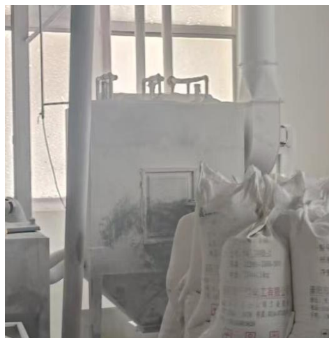
废气处理设施
