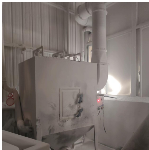
废气处理设施
