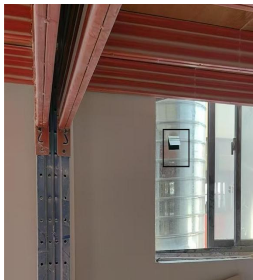
废气收集管道
