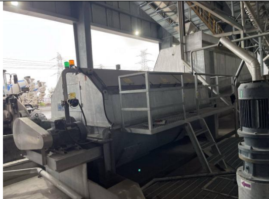
清洗废水处理设施
