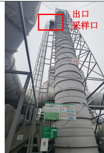
电镀、退镀、刻蚀、污水站废气 DA002 排放口
