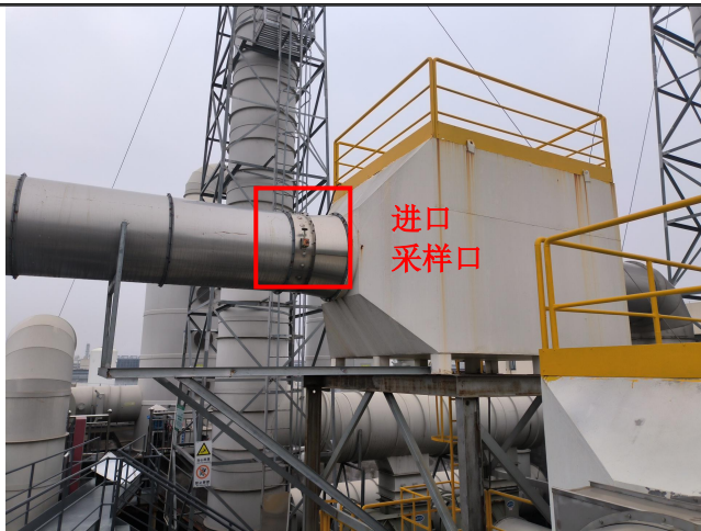
丝网印刷、封边废气治理设施
