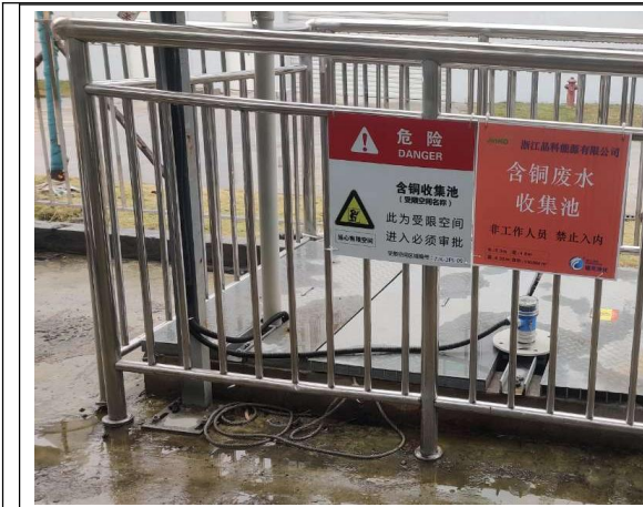
新建污水站含铜废水收集池
