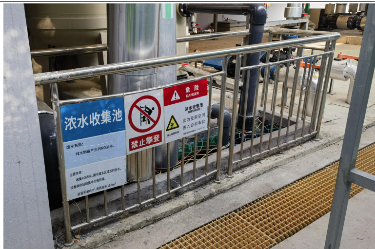
现有污水站浓水收集池
