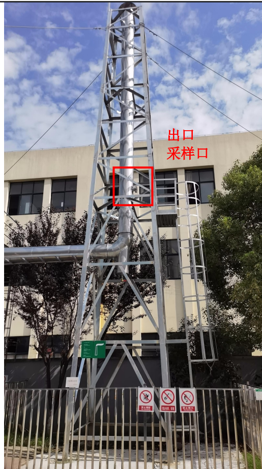
天然气锅炉 DA004 废气排放口
