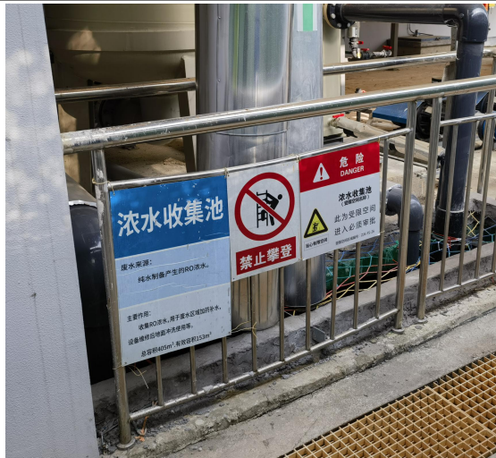
现有污水站浓水收集池
