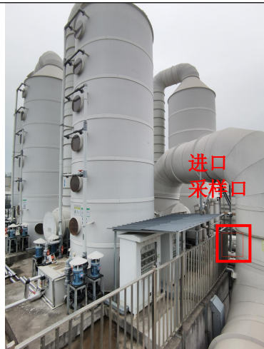
电镀、退镀、刻蚀、污水站废气治理设施
