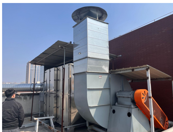
废气处理设施
