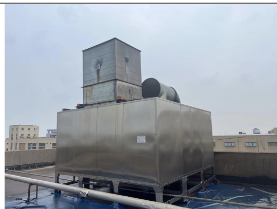
压延废气治理设施“碱喷淋”
