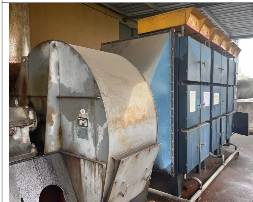
压延废气治理设施“高压静电”
