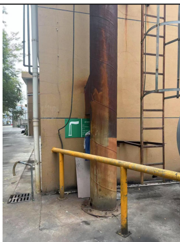
锅炉废气排放口
