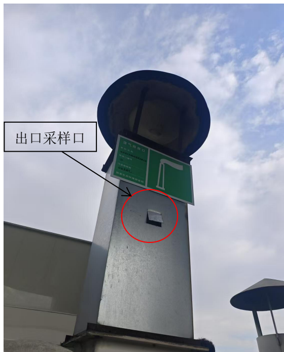
配液废气、检测废气排气筒出口 (DA001)
