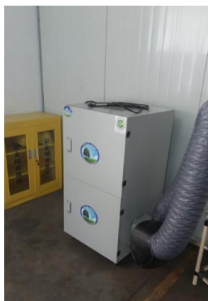
补漆废气处理设施
