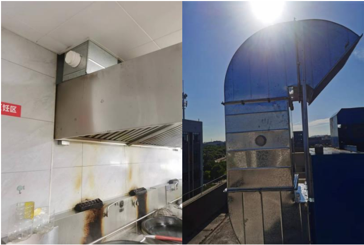
图 3-4 废气处理设施及排放口照片
