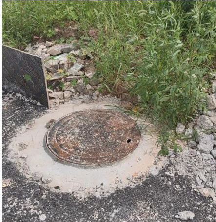
图 3-2 废水处理设施及排放口照片
