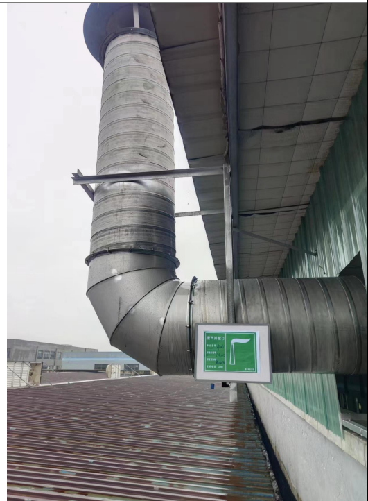
抛丸粉尘排放口标识牌
