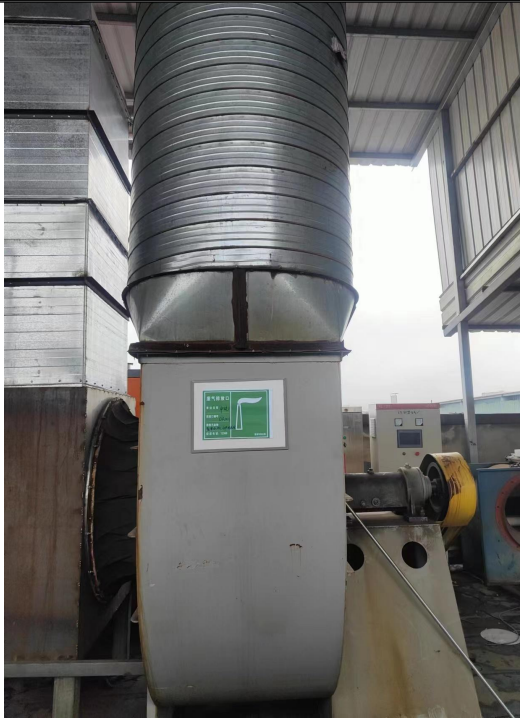
涂装废气排放口标识牌
