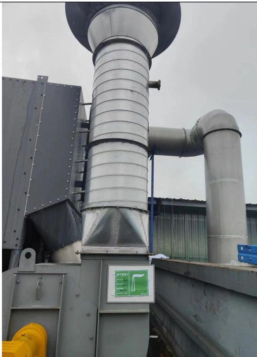
焊接烟尘排放口标识牌
