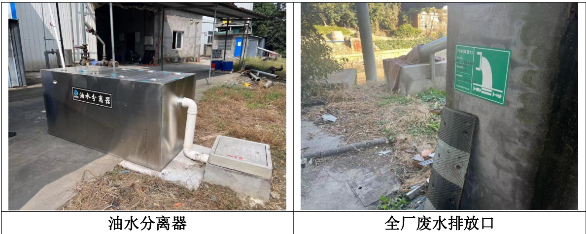
图 4-2 废水处理设施及排放口照片
