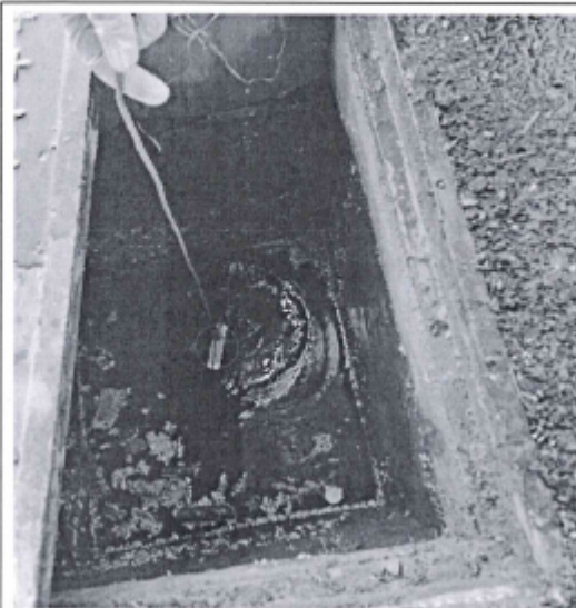
综合废水出口
