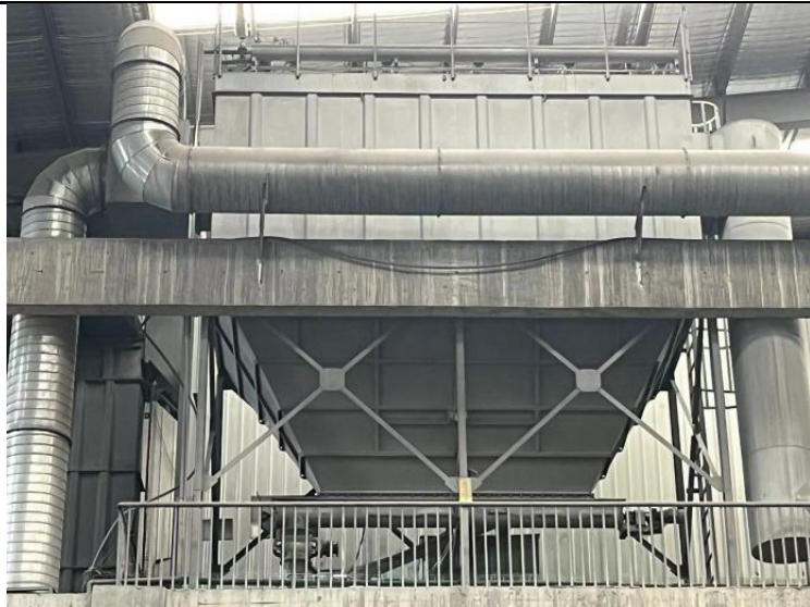
图 2-6 回收料破碎、筛分粉尘处理设施
