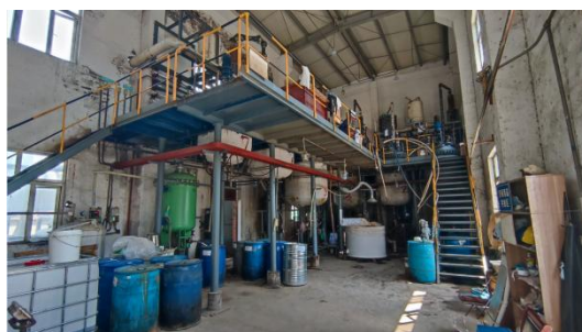
污水处理残渣残液处理间
