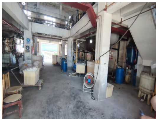
车间二-内部反应釜
