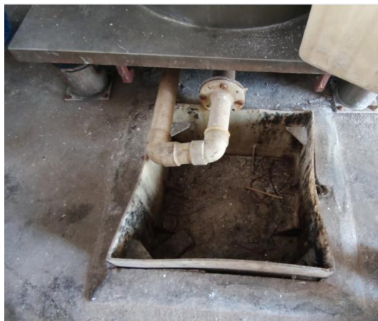
车间一-离心废水收集池
