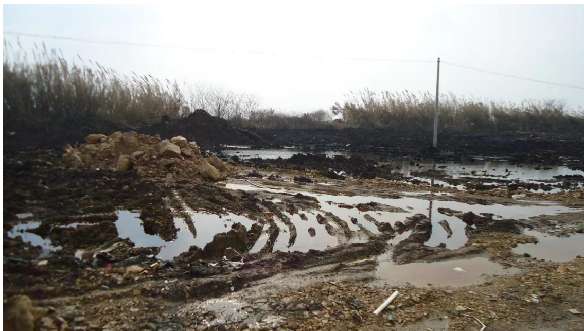
施工渗出橙黄色及黑色地下水
