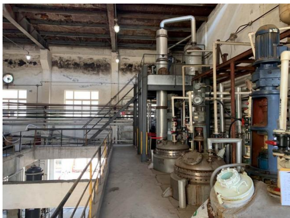
车间一 内部反应釜
